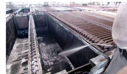
Abb. 4: Elektrolysebecken mit Anodenschlamm
